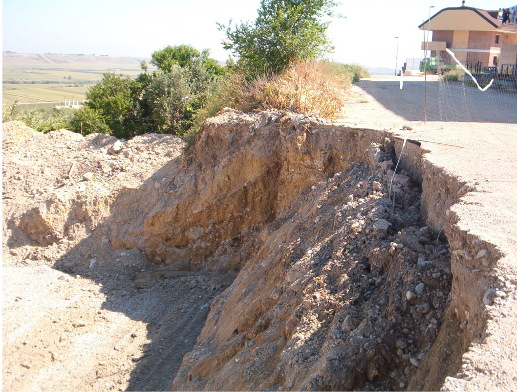
Foto 6: franamento di parte della strada.
